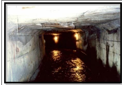
하수암거 황산화 세균으로 인한 콘크리트 부식
