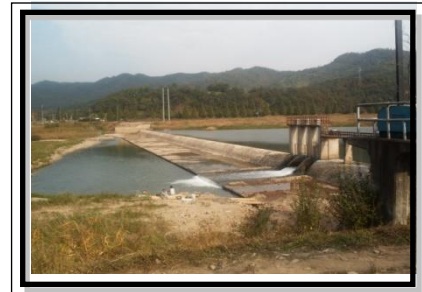
수리시설 동결융해로 인한 콘크리트 부식
