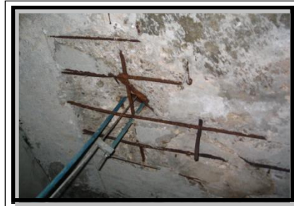
정수장 염산 및 철근 피복부족 으로 인한 콘크리트 부식
