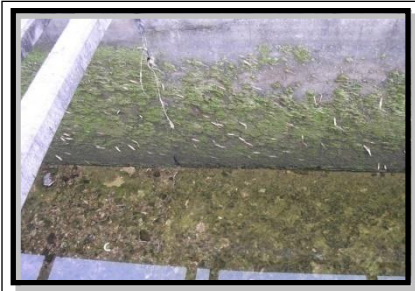
용수로 미생물 번식으로 인한 콘크리트 부식
