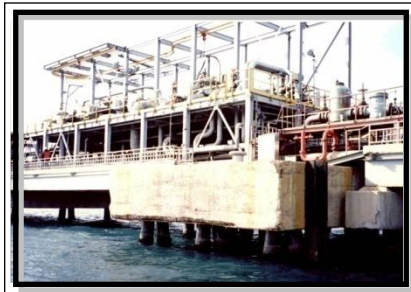
항만 염해로 인한 콘크리트 부식
